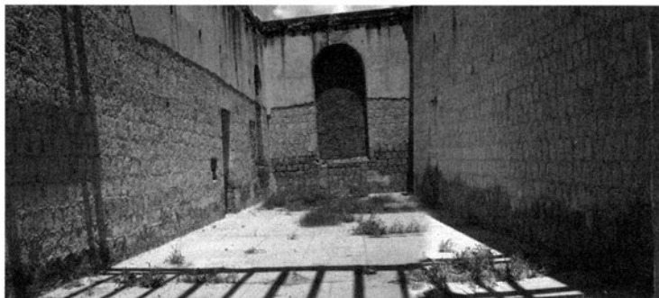
Destrucción de los recubrimientos del muro que tenían los grafitos históricos.
